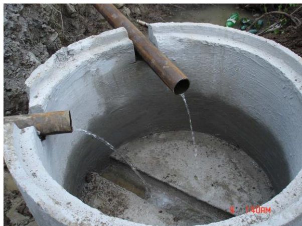
Obr.4 Výtok podzemných vôd zo subhorizontálnych vrto v zbernej šachte
