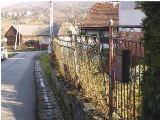
Obr.11 Naklonenie plotu pred RD č.137 a existujúci rigol pri miestnej komunikácii
