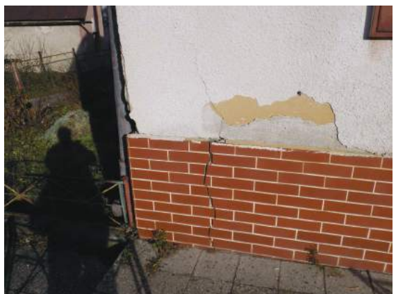
Obr.10: Výrazná prasklina na RD č.137
