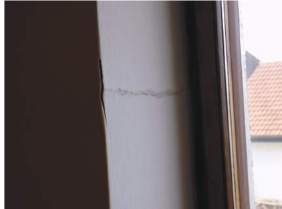
Obr.6: Praskliny v interiéri RD č.270
