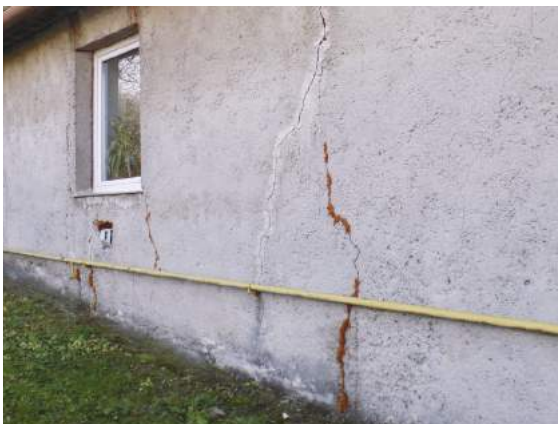
Obr.9: Otvorené praskliny na RD č.138 vyplnené PUR penou
