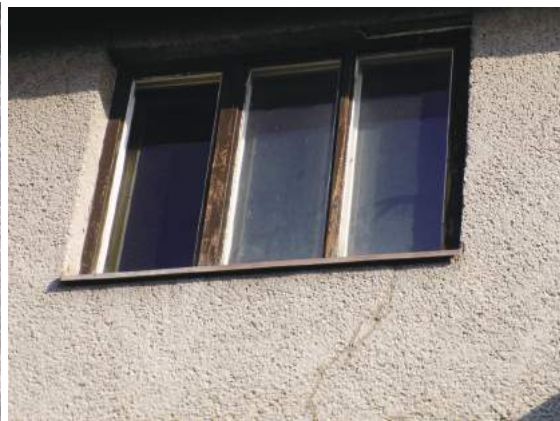
Obr.8: Prasklina na RD č.139
