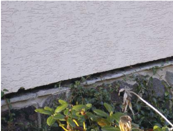
Obr.5: Pokles základu na RD č.270
